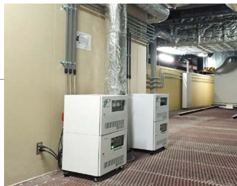
ホールのバックヤードに設置されている「プリンセス」。セパレートタイプなので、設置場所は自由に選べる
